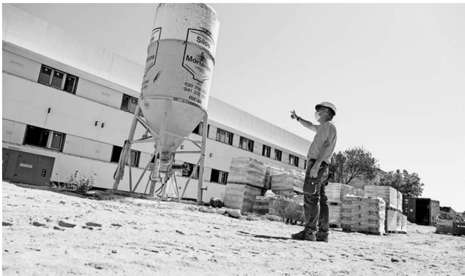
Un operario sigue las obras del IESO El Cierzo (Ribaforada). Educación invierte 4 millones de euros en un centro que prevé abrir en enero. LUIS MIGUEL CHAVERRI
